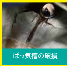
流入管付近の破損
